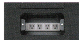
配線開口内部
